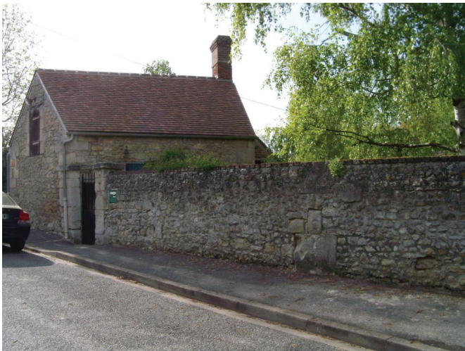
Ce mur de clôture, en continuité avec le bâtiment, est en bon état de conservation. On remarque, au centre, un chaînage.
