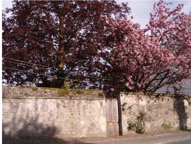
Les couronnements des murs, comme par exemple celui du mur du château ci-dessus, sont essentiels dans la conservation des murs de clôture.
