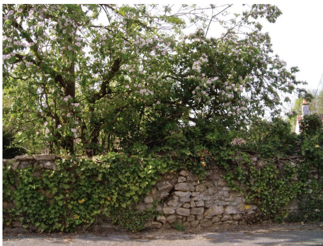
Ce mur ancien en pierres maçonnées, rue des Ecoles, est en cours de dégradation. Envahi par le lierre, une partie des pierres de couronnement sont déjà tombées. Il doit être rapidement réhabilité.
