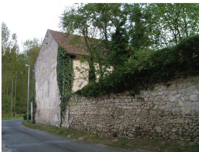
Le couronnement de ce mur ancien, chemin de Fosse, est envahi par le lierre. Pour le conserver, son couronnement devra être dégagé et remaçoné. L'ensemble du mur devra également être réenduit.
