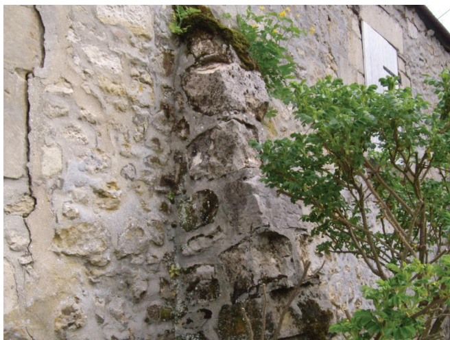
Un contrefort de la ferme du chemin de Carrieuse. Il a été réenduit au ciment, ce qui entraîne une forte dégradation de la pierre calcaire qui s'effrite. Des conseils sont nécessaires pour conserver l'intégrité des bâtiments anciens.
