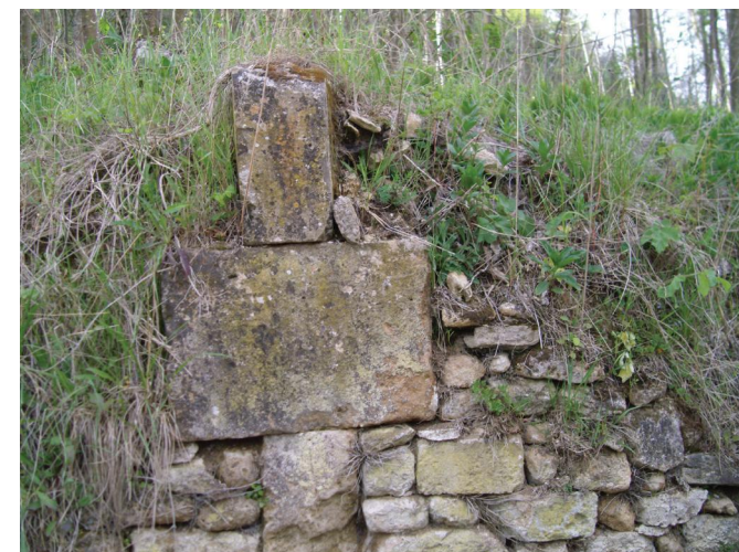
Mur ancien ruiné, chemin de Fosse : seule la partie la plus solide a résisté.
